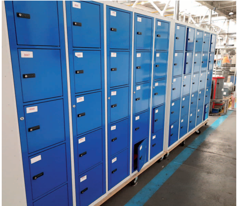
■ Figura 8 ■ Taquillas exclusivas para la entrega de ropa contaminada y recogida de la ropa limpia
